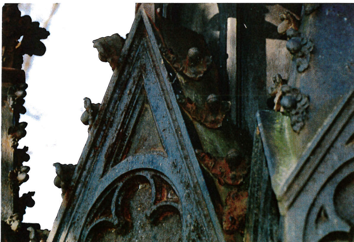
LOKALIZACE: kříž – detail podstavce s novogotickou ornamentální výzdobou ETAPA: současný stav poškození korozí a havárií
