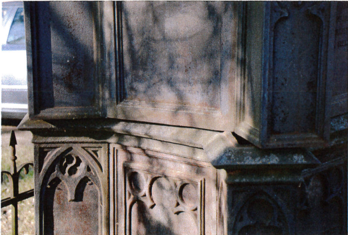
LOKALIZACE: kříž – detail podstavce ETAPA: optický průzkum vychýlených částí podstavce
