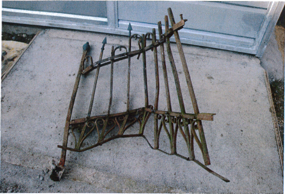
LOKALIZACE: kříž – pohled na segment ohrádky ETAPA: současný stav poškození havárií
