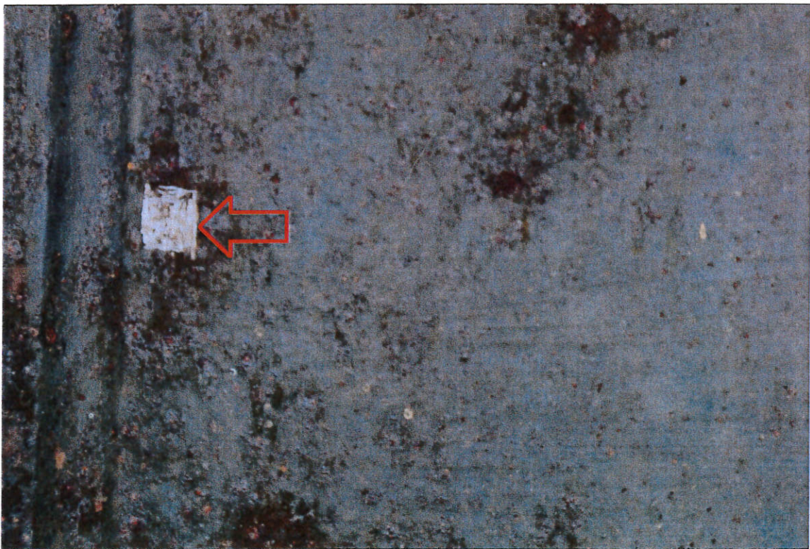
LOKALIZACE: kříž – detail stěny podstavce ETAPA: sonda pod povrchovou korozi – šipka ukazuje na očištěnou litinu
