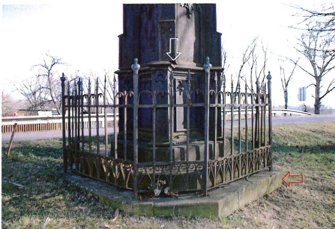
LOKALIZACE: kříž – pohled na spodní část s ohrádkou ETAPA: optický průzkum – bílá šipka ukazuje na vychýlení konstrukce z osy červená šipka označuje kamennou základnu kříže
