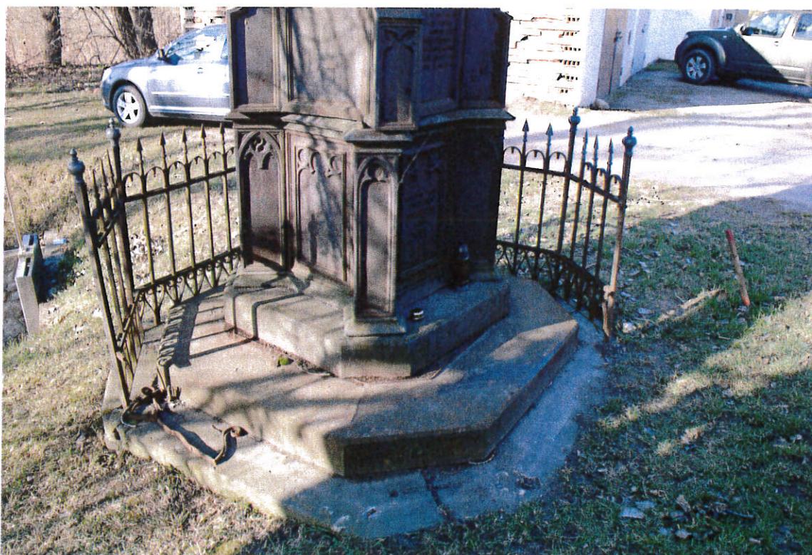
LOKALIZACE: kříž – pohled na ohrádku ETAPA: současný stav po havárii a odklizení poškozených částí
